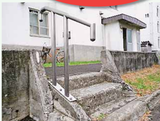
東区伏古団地に設置された手すり
