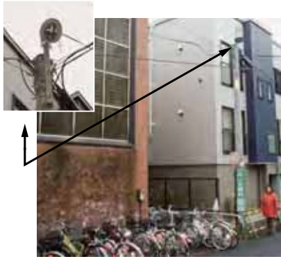
駐輪場に設置された街灯
